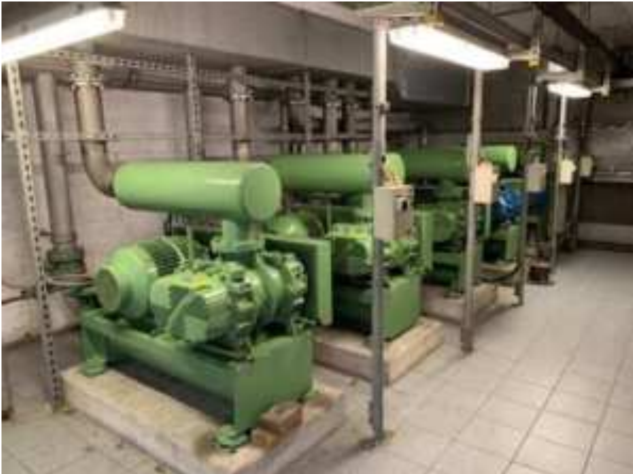
Figure 3-10 Photo des surpresseurs air process et air de lavage biopur© C et filtre bicouche à remplacer
