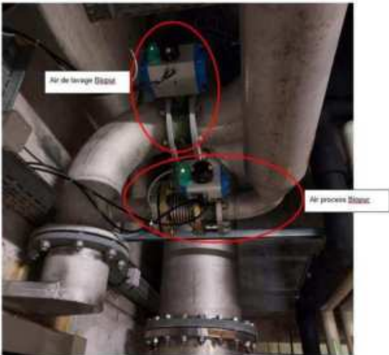
Figure 3-9 Photo des vannes d'air de lavage et d'air process Biopur© C
