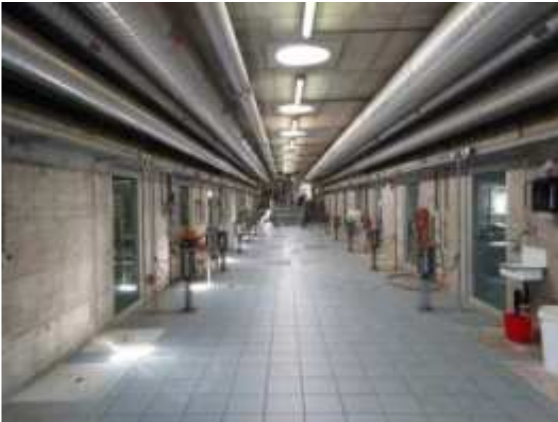
Figure 3-4 Photo des vannes d'isolement à remplacer
