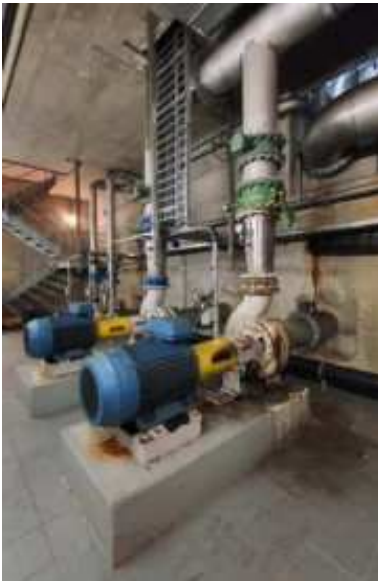
Figure 4-7 Photo des pompes d'eau de lavage biopur et filtre bicouche à remplacer
