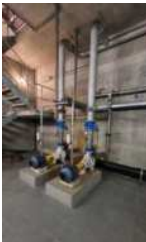
Figure 3-11 : Photo des pompes centrifuges eaux sales à remplacer
