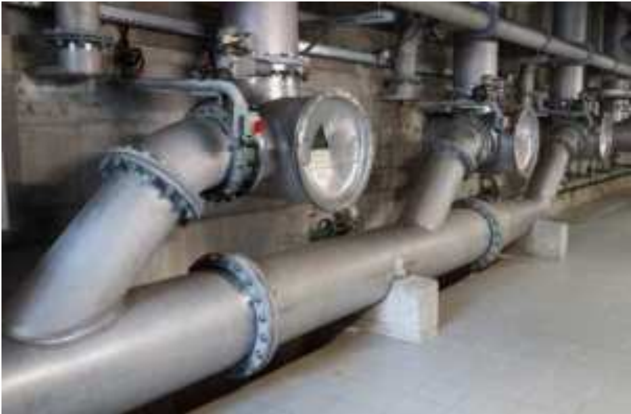
Figure 4-5 Photo des vannes d'isolement sortie des filtres bicouches
