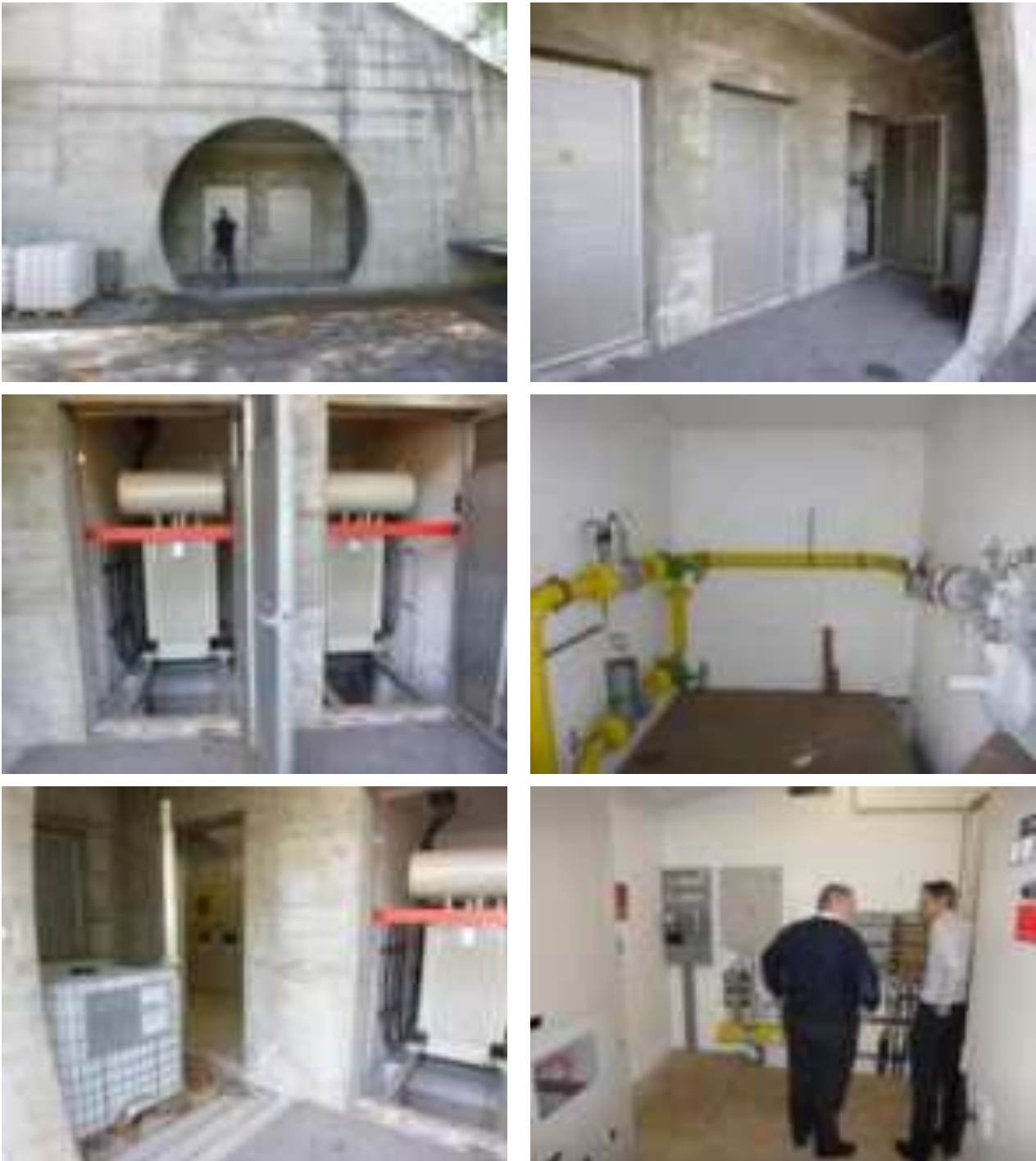
Figure 2-5 Photos du local technique contenant les transformateurs, l'arrivée de gaz naturel et l'introduction de la fibre optique.
