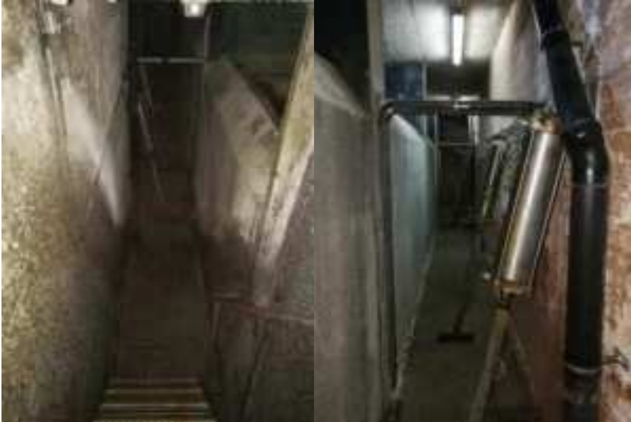
Figure 4-6 Photo des clapets d'eau boueuse des filtres bicouches
