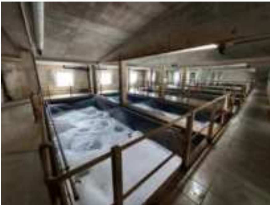
Figure 3-7 Photo des rampes d'abattement de mousse sur les Biopur© C
